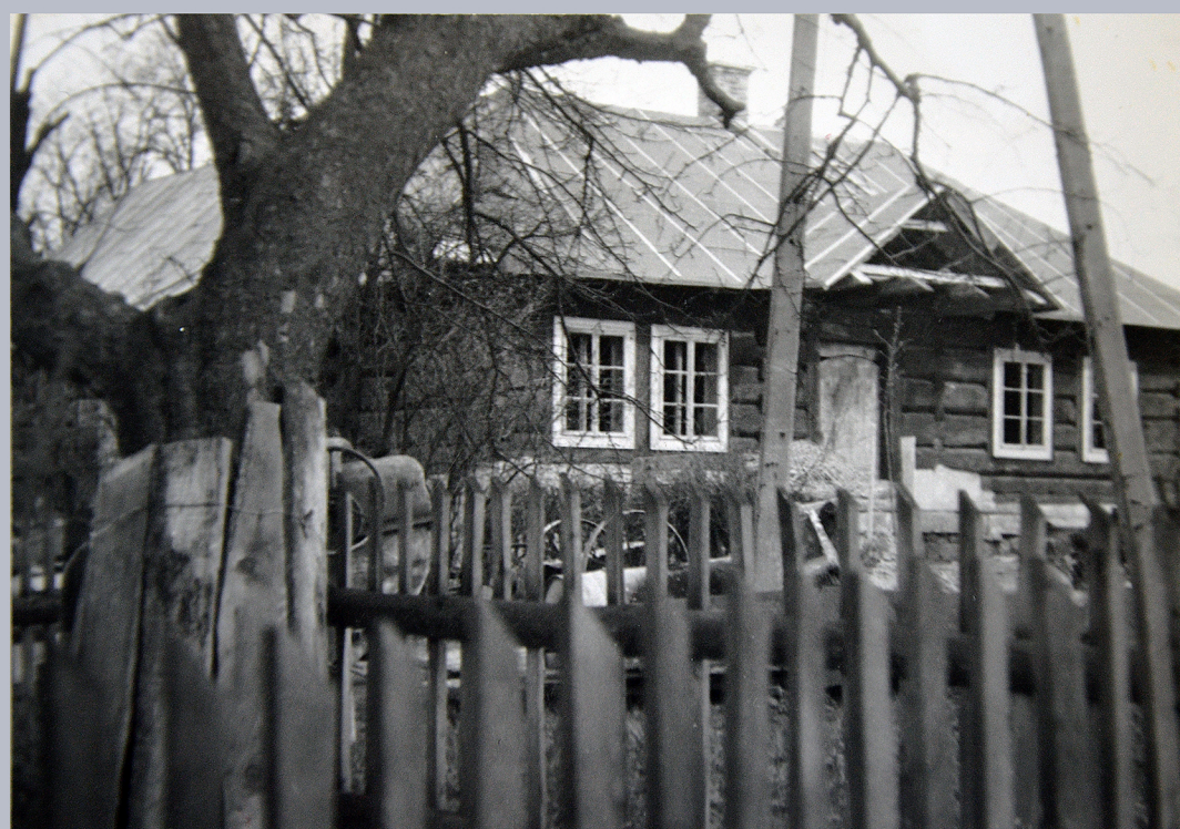
Prace remontowe „Koryznówki” w maju 1980r., w której rok później otworzono Muzeum Pamiątek po Janie Matejce. Fot. arch. J. Kokoszka.
