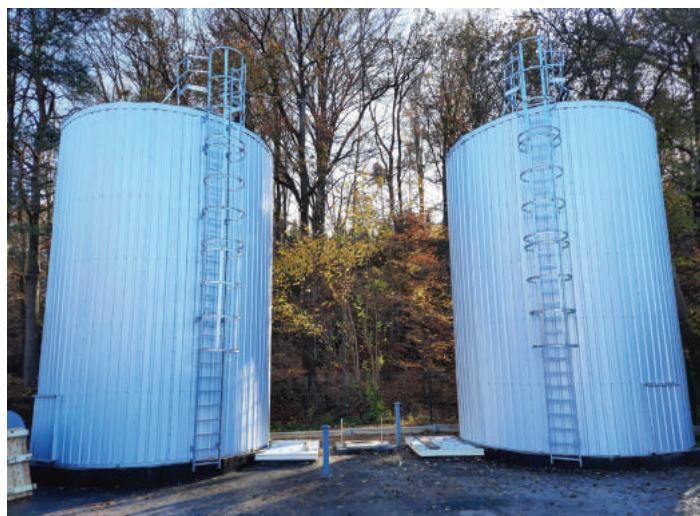
Stacja uzdatniania wody- Leksandrowa
